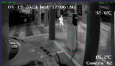
Ladestationen für Elektrofahrzeuge
